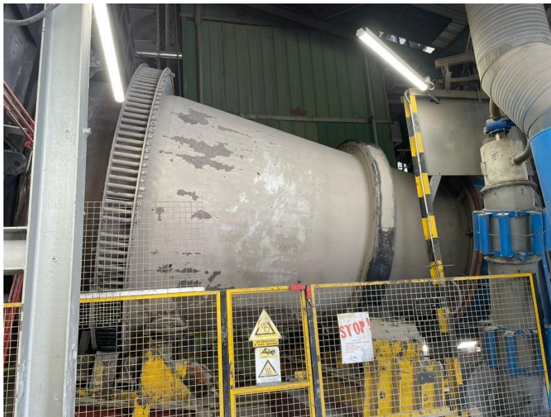
Figure 4 : Four Existant (Source : Setec Energie Environnement)
